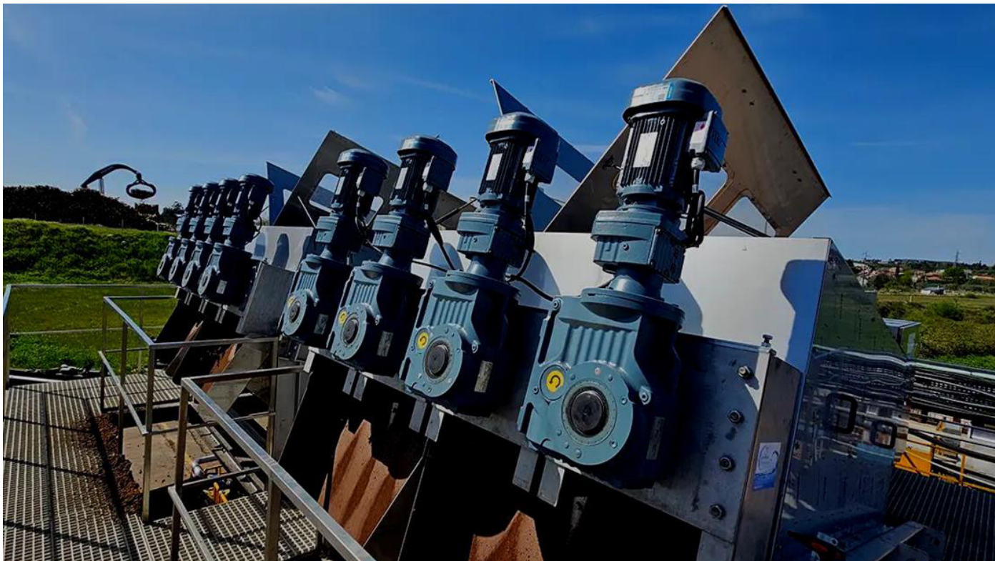
Imagem de 2 unidades KMDS 414 instaladas numa Indústria de Aglomerados de Madeira.
